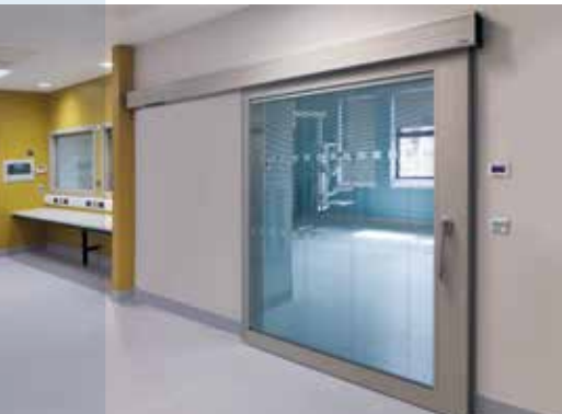
▲ Irlande - Silgo : Unité de soins intensifs, Portes vitrées coulissantes hermétiques
